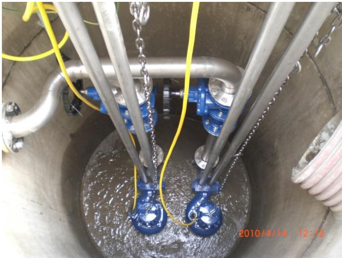
vystrojení mělké areálové čerpací stanice splaškových vod s čerpadly Hidrostral
